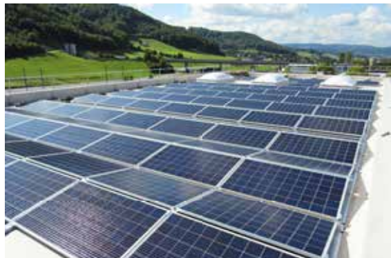
Auf dem Dach der Produktionsanlage wurde auf einer Fläche von 1'500 m 2 eine Photovoltaikanlage installiert
